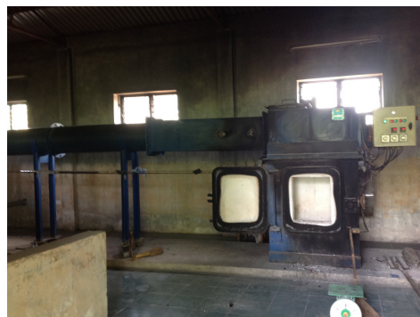
Lò đốt tại BVĐK KV Lục Ngạn
