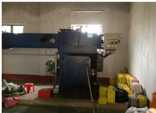
Lò đốt BVĐK TP. Bắc Giang
